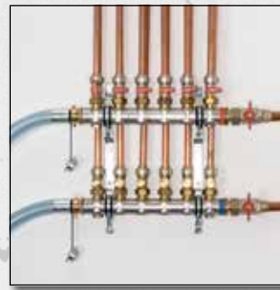
Spülen von Radiatoren- und Flächenheizsystemen (S/SL/SLW)
